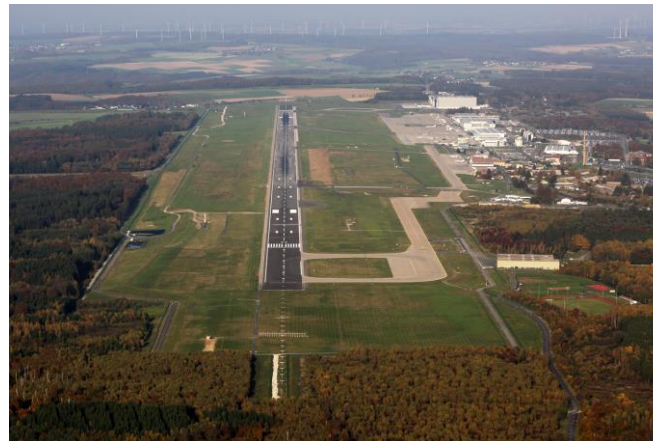
Komplettausbau Flughafen Frankfurt-Hahn mit u.a. umfangreichen Geländeregulierungsmaßnahmen, Beton-/ Asphaltflächen: ca. 65.500 m 2 , S/L-Bahn-Verlängerung, Rollbahn-/Entwässerungssysteme, versetzter Schwelle 03, Speicherbecken für Enteisungsmittelhaltiges Wasser (44.000 m 3 )
